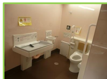
多目的トイレ（長岡京市）
