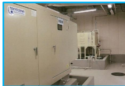
自家発電機（那珂川町）
