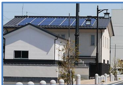
太陽光パネル（現防災センター）
