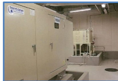
自家発電機（那珂川町）
