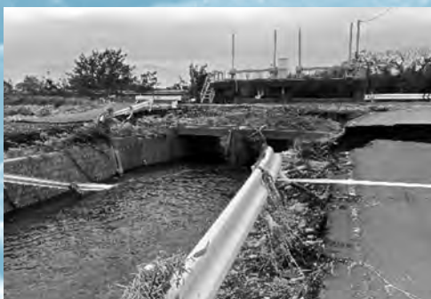
基幹排水路恵川樋門 被災状況
