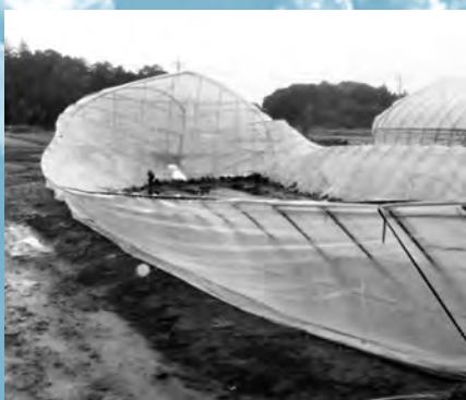
被害を受けたビニールハウス
