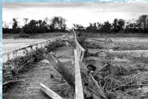
通学橋 被災状況
