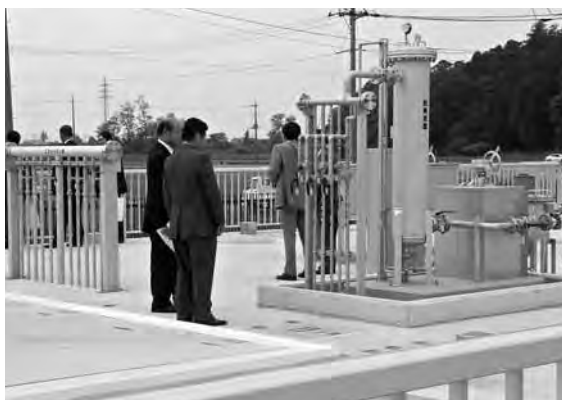
処理施設の脱臭装置
