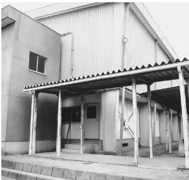
早期着工が待たれる老朽化した体育館
