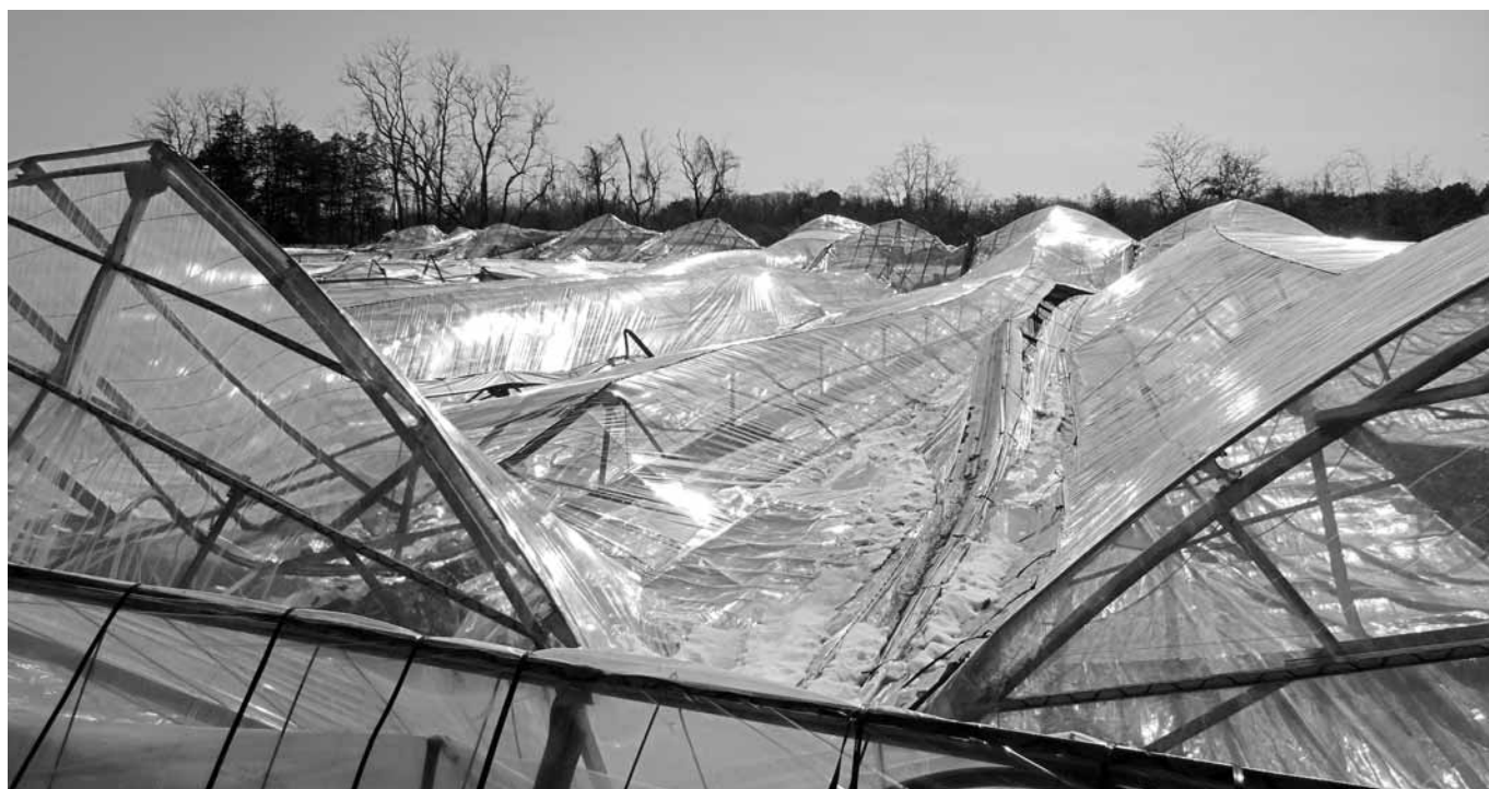
倒壊したハウス
