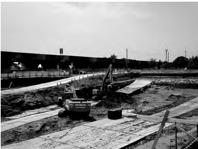
一部工事が始まった六美町北部土地区画整理事業地内
