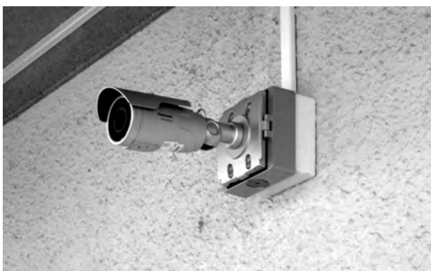
設置した防犯カメラ
