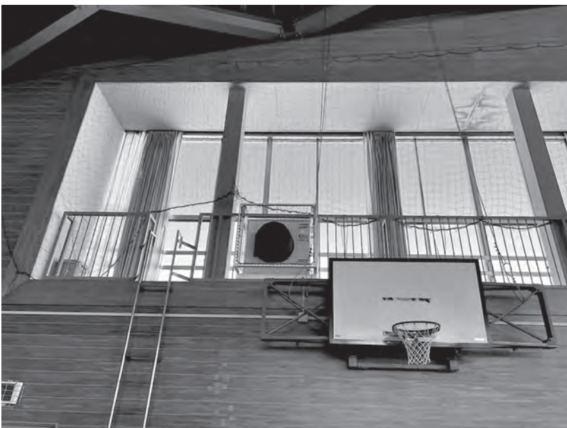
壬生中学校第2体育館に設置されたエアコン
