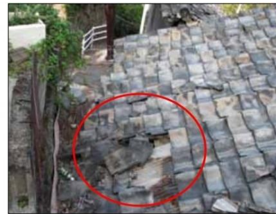
瓦の一部に剥離とズレがあり、 雨漏りのある例
